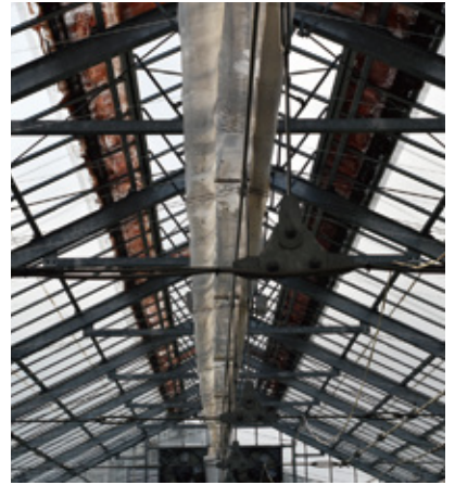
温室ハウス内設備の様子
