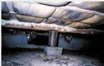
湿気が原因で木材が腐朽
