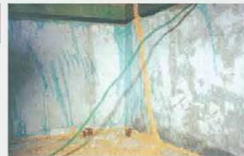
ベタ基礎を突き抜け蟻道を作って侵入
