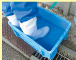
踏み込み消毒槽の設置
